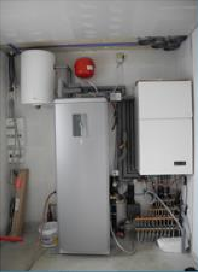
Figur 9. Varmepumpeinstallation i Silkeborg.
